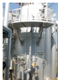
廃熱ボイラー
