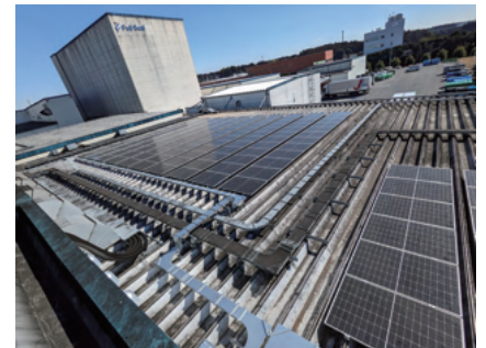
筑波工場のソーラーパネル
