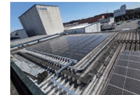
筑波工場のソーラーパネル
